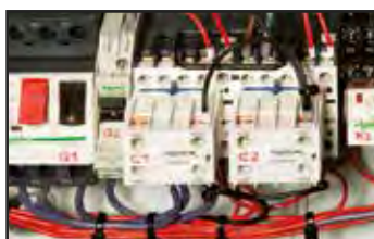
Protector magnetotérmico mediante disyuntores.
